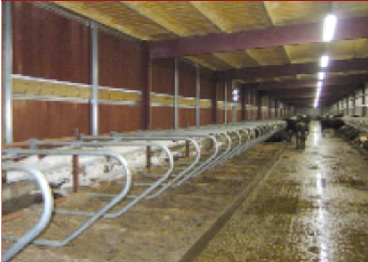
Figuras 13 y 14. Refrigeración mediante paneles humectantes y extracción mecánica de aire
