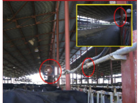
Figura 16. Rociadores y ventiladores
